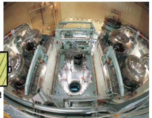
▲原子力発電所の内部(中央の円形が原子炉容器)
